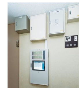
村役場の照明制御盤、電力計測器
