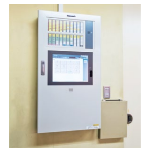
体育館の照明制御盤
