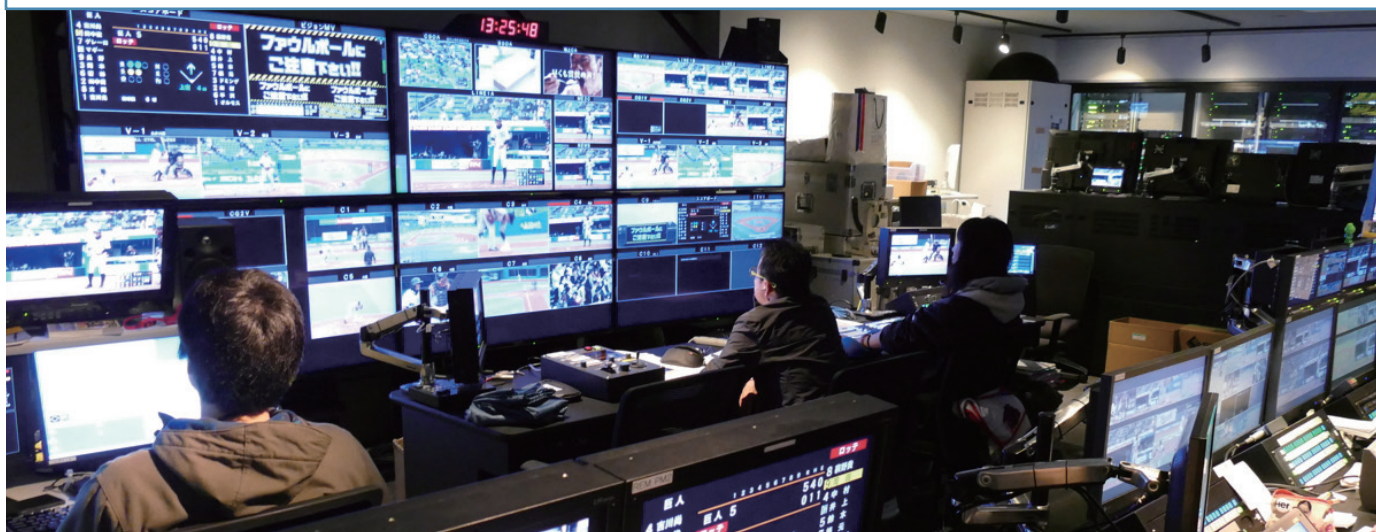
設備が導入された中継室
