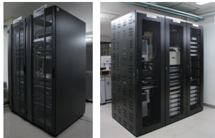
下の階にある主装置
