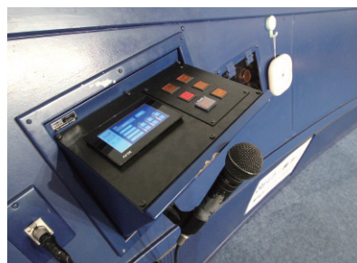
シアターに組み込まれた操作パネル
