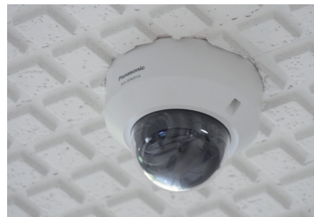
設置された監視カメラ (WV-SFN311A)
