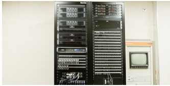
デジタル化によりコンパクトになった電力増幅架(左)と入力パッチ架(右)
