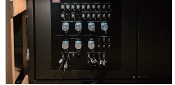
デジタル化されてスッキリした舞台袖音響パッチ盤
