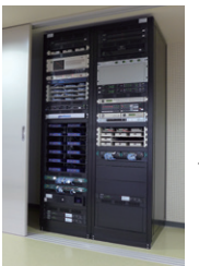
◀室内後方には機器収納架も設置。向かって左側がサイネージシステム用、右側が多目的ホール用。通常は扉を閉めてある。
