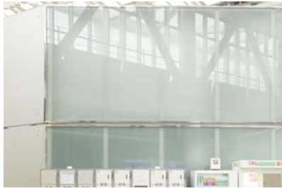
エントランスに設置された12面マルチの裏側。すっきりと収納
