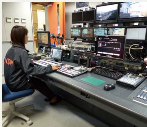
辻堂の拠点に設置された2ME ライブスイッチャー AV-HS6000
