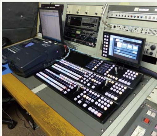
鎌倉の拠点に設置されたライブスイッチャー AV-HS6000 コントロールパネルはコンパクトサイズのAV-HS60C4を採用
