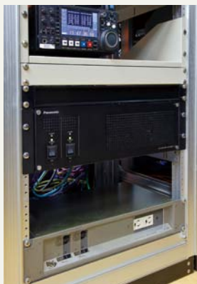
小金井のスタジオ・サブに設置された2ME ライブスイッチャー AV-HS6000のメインフレーム
