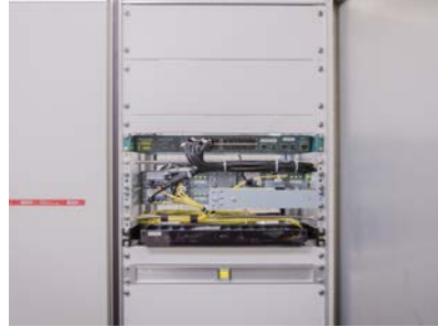
各駅に設置された表示制御装置
