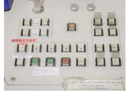
各駅に設置された放送操作盤
