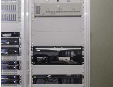
指令所に設置された案内表示中央装置
