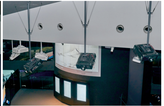
◀ 展示ゾーンに所狭しと吊られたプロジェクター。天井材の色味に合わせて白色と黒色のキャビネットを使い分けることで、建築との調和が図られている。壁面も天井も傾斜しているため、同じ角度、同じ高さで吊られているプロジェクターはない。設計の際には3次元的にシミュレーションが綿密に行われた
