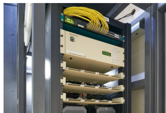
▲バックヤードのスイッチャーも更新 収納場所も改め、メンテナンス性を高めた
