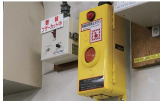
▲転落検知が通知された場合は、駅務室の非常停止ボタンを押して、事故を未然に防ぐ。
