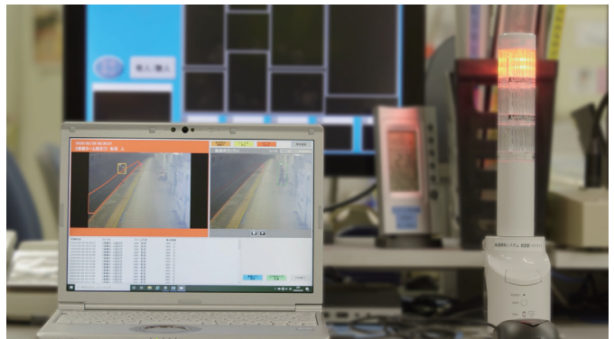
▲駅務室に設置された監視端末にはリアルタイムで検知映像が表示されている。転落検知をした場合は映像とともに警告灯でも通知される。
