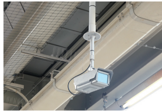
◀経堂駅にはすでにパナソニックのセキュリティカメラが導入されており、このうち8台のカメラが線路に面した映像を捉えている。
