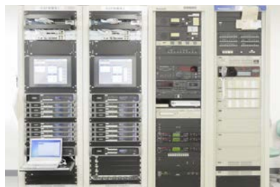
左二つのラックが改修対象のDSP制御架
