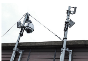
市役所屋上に設置された防災カメラと 25GHz 無線伝送装置
