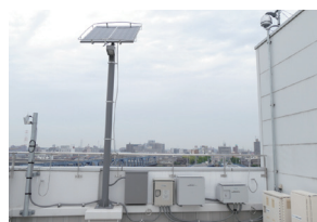
すべてのカメラ設置場所に大型蓄電装置も整備
