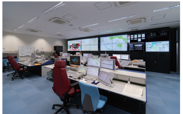
▲マルチスクリーンの奥行きが少なくなったことで、指令スペースを広く確保
