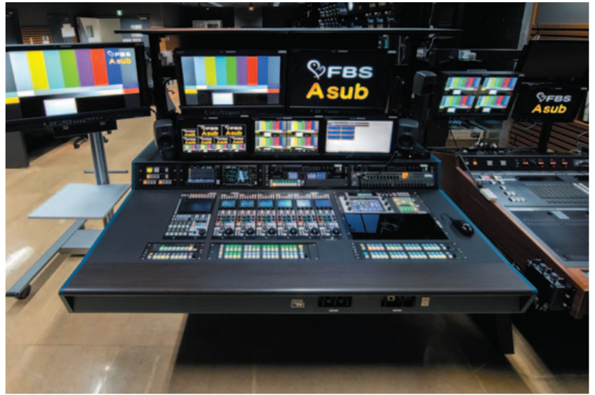
▲VE卓の左端にモード選択ボタンが、手前中央にルーター切り替えパネル(アサインパネル)が、そして右端にはコンバーターモニターが設置されている
