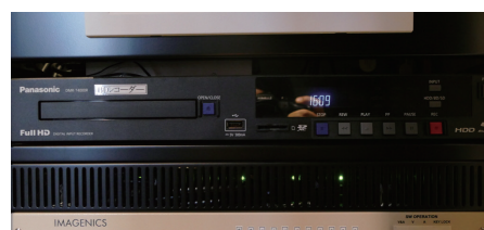
AV設備室に置かれたDMR-T4000R。イベント内容の収録が可能
