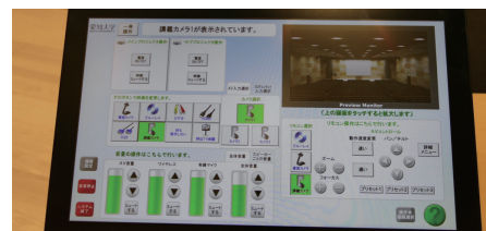
コントロールは壇上と制御室から可能
