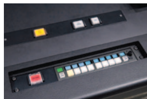
▲TAKEボタンの下には、緊急時にマニュアルスウィッチングへ切り替え可能なEMGボタンを設けた
