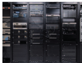
▲AサブとNサブのスイッチャー・ルーター・ペリフェラルが収まるラック
