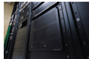
▲AサブとNサブで共有しているルーティングスイッチャーAV-WM7400(108入力×90出力)
