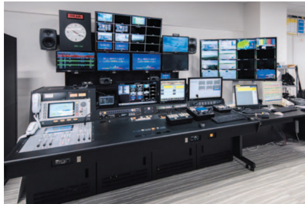
▲C-OTCが導入されたNサブ。Nサブは速報性を重視し報道フロアの内部に構築した
