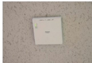
▲計22台のWi-Fi基地局
