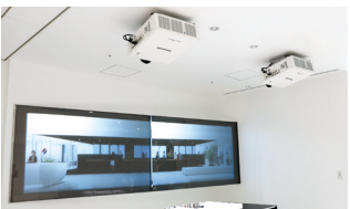
▲PT-RZ670Jは白い壁、天井に溶け込み存在感を抑えています
