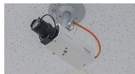
屋内対応ネットワークカメラ WV-SPN310AV 4台病室 (4床室)
