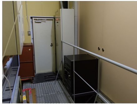
電源制御盤・表示部機器収納架 外観
