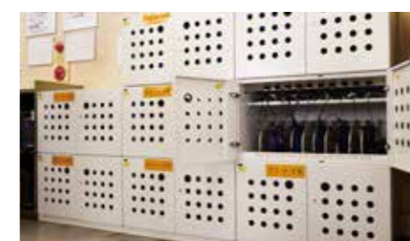
効率的に運用ができるよう事務所には約80台が収納できる充電ラックを設置。
