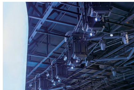
▲曲壁面に沿って均等にプロジェクターが配置される
