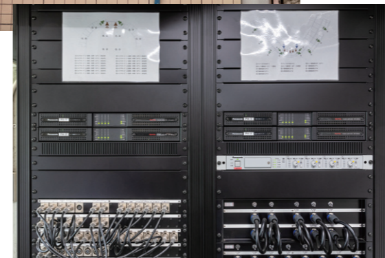
▲ 調整室内のラック。4台のデジタルパワーアンプWP-DM924と1台のワイヤレス受信機WX-SR204Aが収納されている
