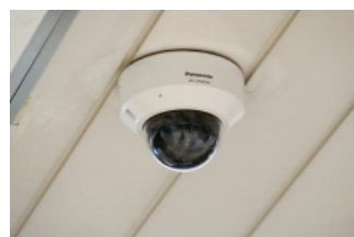
▲監視カメラは既設の設備を活用
