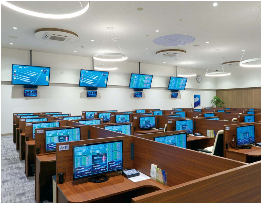
▲リニューアルに際して新設された有料席には、前面にTH-70LF50Jを4台設置。54席ある個別シートには、オッズ情報を表示するモニターが設置されている
