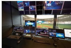
▲映像、音響、照明を一括制御するコントロールルームの総合演出システム
