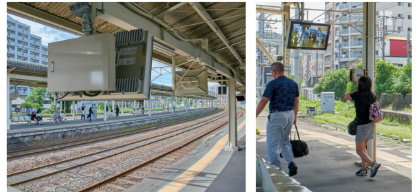
▲ハウジングレスにより軽量化が図られ、ホーム幅の狭いケースなどの難しい設置環境でも導入が可能だった(写真:鹿児島駅)
