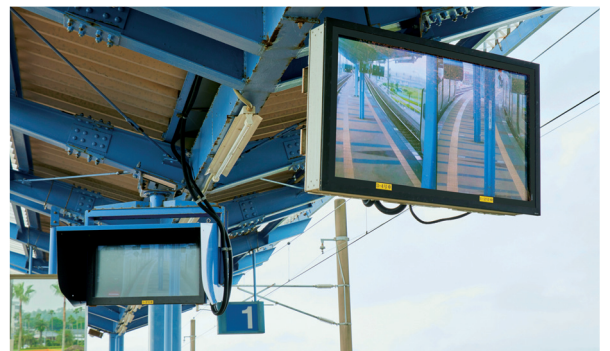
▲既設のハウジング付モニターも併用されているが、視認性は大きく違う(写真:宮崎空港駅)
