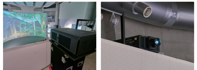
▲2台のPT-RZ12KJで映像をブレンディング。円形スクリーンへの投写ということもあり、設置調整には幾何学ゆがみ補正などの自動調整が可能な「自動スクリーン調整アップグレードキット」が活用された
