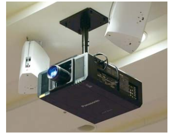
▲ホール中央に増設されたPT-RZ21KJ。両サイドにはアレイスピーカーも2台増設されホール全体の音響も再調整した
