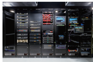
▲ 報道サブのラック室に配備されたファイルベースシステムのラック架。計4本のラックにシステムが収納されている
