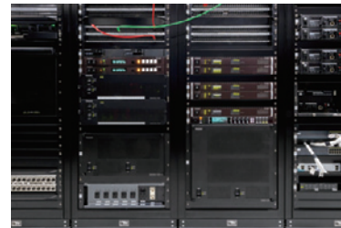
▲報道サブのラック室に格納されたライブスイッチャーAV-HS7300、ルーティングスイッチャーAV-WM7300(72×72)、ペリフェラルAV-PF3000シリーズ
