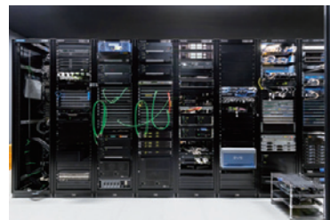
▲ 制作サブのラック室
