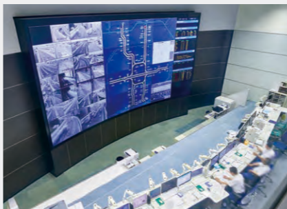
70型スクリーン・縦4面×横6面の計24面の大画面。明るい交通管制室内でも鮮明な映像を投写
