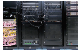
▲L1サブのライブスイッチャーAV-HS7300と、全サブで共有化したルーティングスイッチャーAV-WM7400
