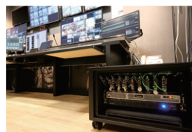
▲Kairos Core 100などが設置されたラック
