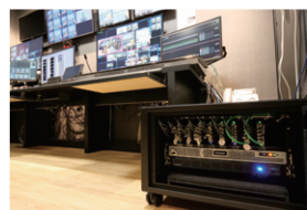
▲Kairos Core 100などが設置されたラック
