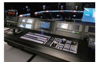
▲コントロールルームに設置されたライブスイッチャーAV-HS6000。64入力×64出力で入出力の多いライブ中継などにも対応できる
