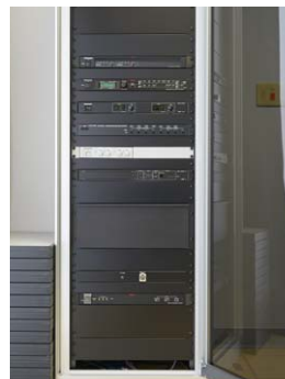
◀音響系の機器収納ラックも今回の更新で大幅な省スペース化を実現。機器が減ったことで省エネにも貢献している
