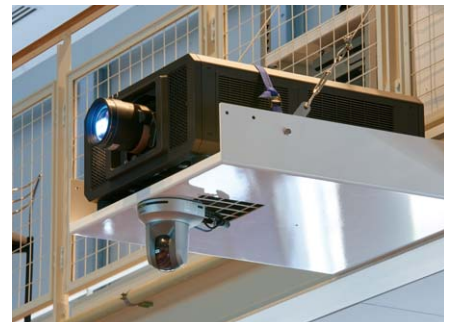
▲ホール中央に設置されたPT-RZ12KJ。設置台の下面には当社製リモートカメラが取り付けられ、メインカメラとして実験の様子などを記録している
