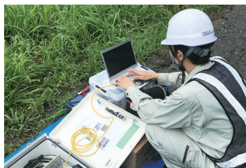
▶災害発生の日にはパナソニックの社員が現地へ入り災害対策用カメラを施工・設置
