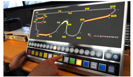
管制室に設置されたLEDパネル型信号機のコントローラー
