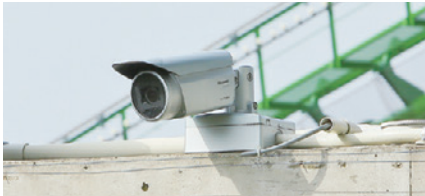
屋外ハウジング一体型カメラは観覧スペースに向けて設置し来園者の安全を確認
