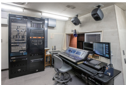
▲小ホールの音響調整室の様子
