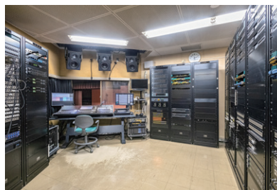
▲大ホールの音響調整室の様子
