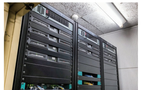
▲小ホールのラック架におさまったデジタルパワーアンプWP-DM900シリーズ
