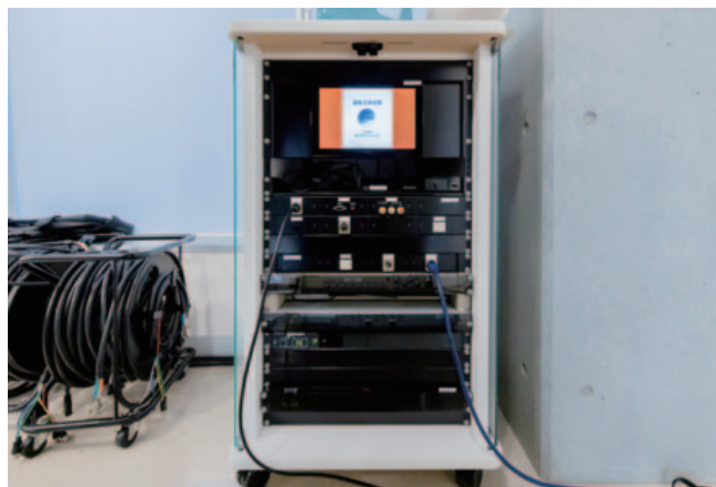
▲ パーテーションを外した際の設定も簡単に行えるワンタッチコントロールパネルとワイヤレス受信機WX-SR202Aなどが収められたラック
