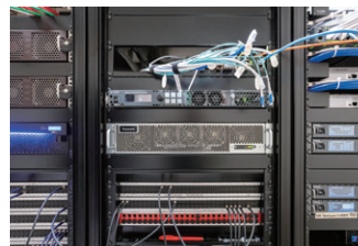
▲ KAIROSのメインフレーム。2Uの小型サイズでラック室の省スペース化に貢献した
