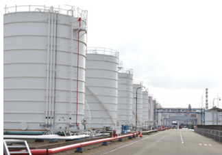
▲石油製品、石油化学製品、油脂などの液体危険物タンクが立ち並ぶ敷地内。
