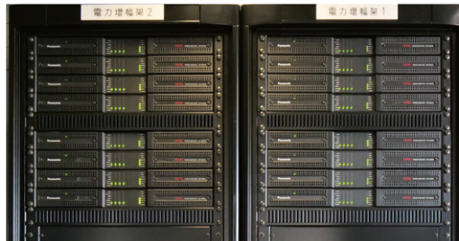
デジタルパワーアンプWP-DM948/WP-DM924が16台格納されている音響システムラックの一部
