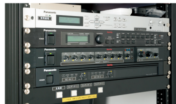
◀スピーカーなど音響機器もパナソニック製品を導入され、スピーカーアンプやマルチプロセッサがバックヤードにまとめられている
