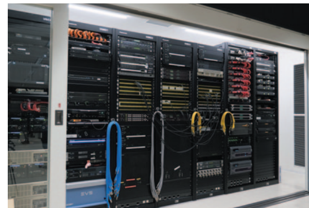
▲第1サブ横のラック室にスイッチャー、ルーター、ファイルベースをコンパクトに格納。右側2架がファイルベース架で左側4架がVIDEO架
