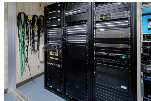
▲制作サブ内のラック。制作サブのスイッチャー本体と共有のルーター、ペリフェラルが格納されている
