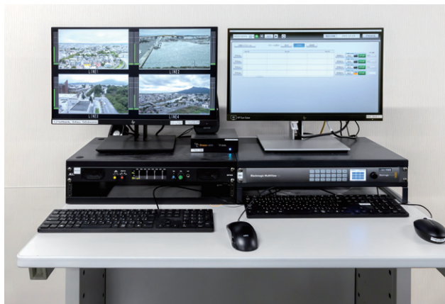
▲報道フロアに設置された回線収録卓
